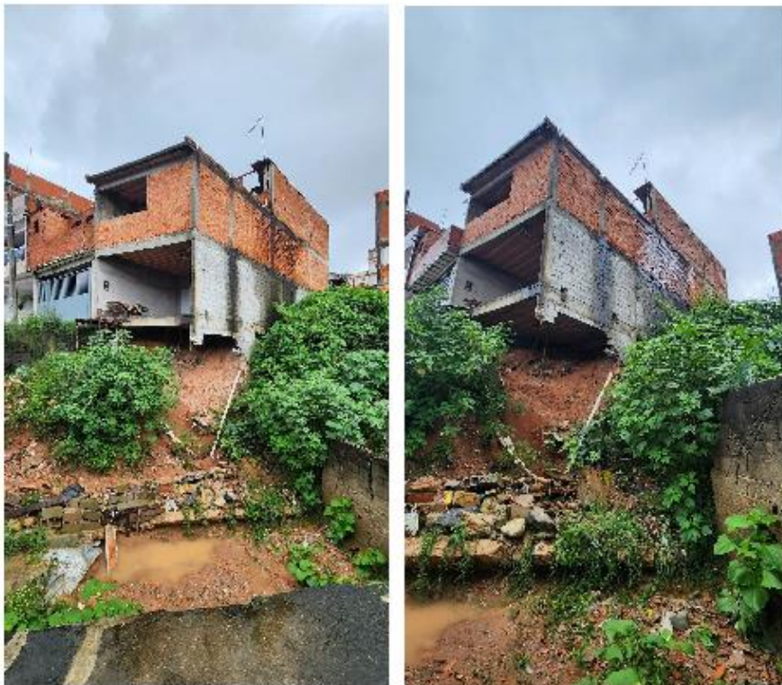
Fotos 2 e 3 – Imóvel localizado na Rua Metodista, 50 – Jardim Maria Beatriz – Carapicuíba/SP. Como é possível visualizar nas fotos, a casa está parcialmente em “balanço” devido ao desmoronamento parcial de terra.
