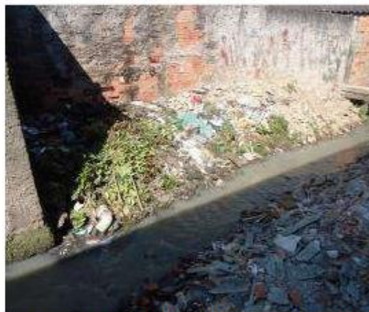
Figura 15 - Deposição de Sedimentos
